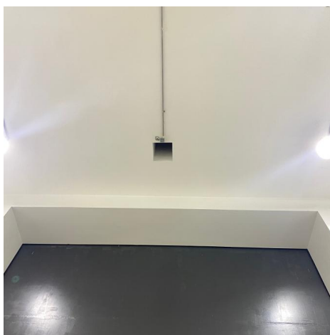
第四探伤室进风口
