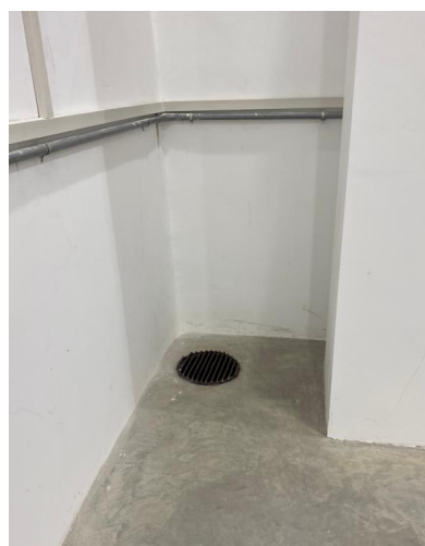
第五探伤室出风口
