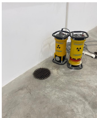
第四探伤室出风口
