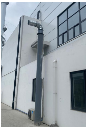
探伤室排气筒
